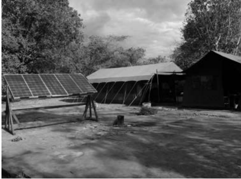
(c) Système photovoltaïque dans une réserve au Kenya
