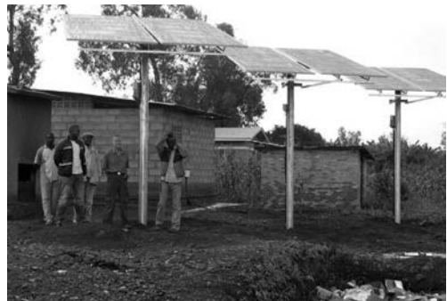
(b) Panneaux montés sur des mâts dans un centre de santé Rwandais (Walt Ratterman second à partir de la droite)
